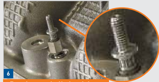
6 Bruch unterhalb des 6-kant
